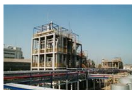
大型蒸留装置
