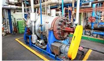
脱水・オリゴマー化・水素化反応装置
