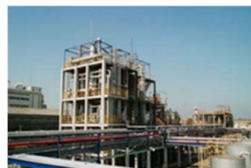
大型蒸留装置
