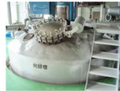
発酵槽（イソブタノール生産）
